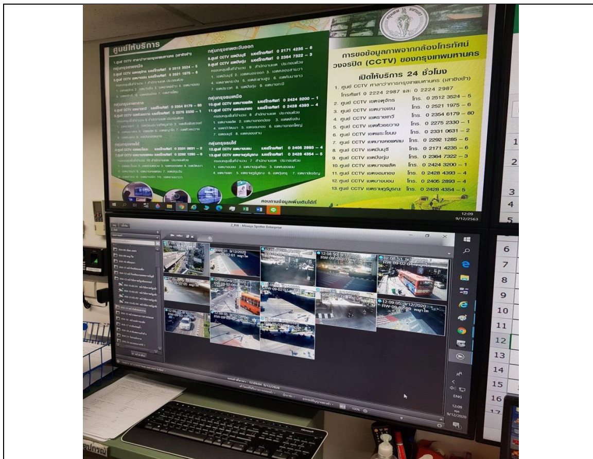
กล้อง CCTV ที่มีอยู่แล้วของสำนักงานการจราจรและขนส่งกรุงเทพมหานคร
